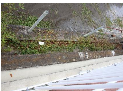
北側護岸の上部割れ目から繁茂
